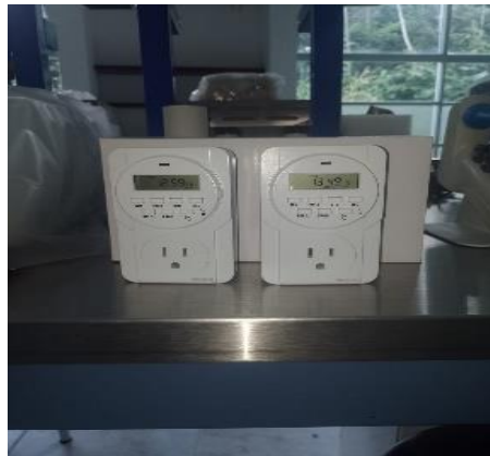
Fig.18.Timers en el control de encendido de equipos de laboratorio.
