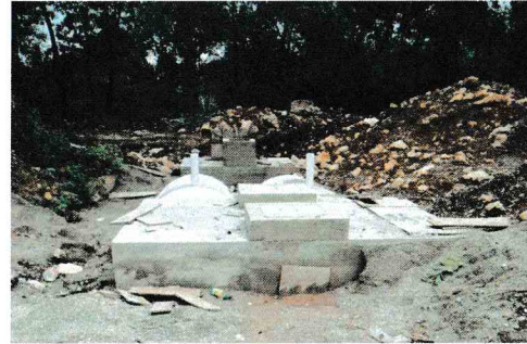
F2: Planta de tratamiento
