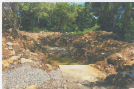
F1: Planta de tratamiento
