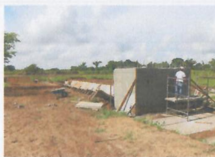
F4: Planta de tratamiento
