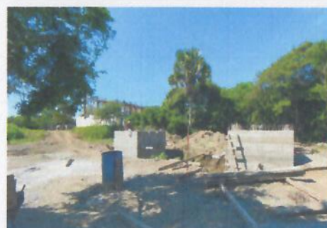
F4: Planta de tratamiento
