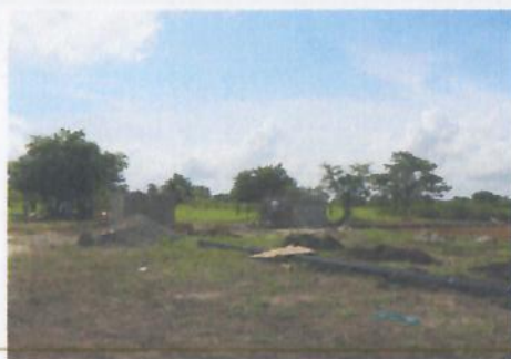
F1: Planta de tratamiento
