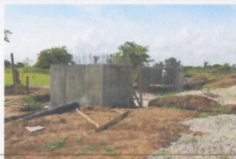
F2: Planta de tratamiento
